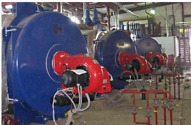
Новая котельная в пос. Ванавара Красноярского края с горелками Weishaupt RMS 11 и RMS 70
