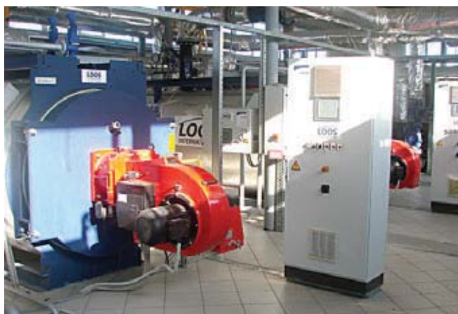
Котельная макаронной фабрики ООО «МакПром»
