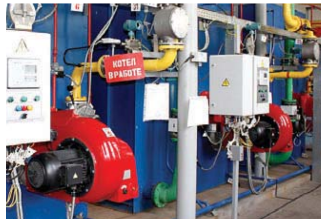
Котельная 35 МВт в микрорайоне Акуловский, г. Пермь
