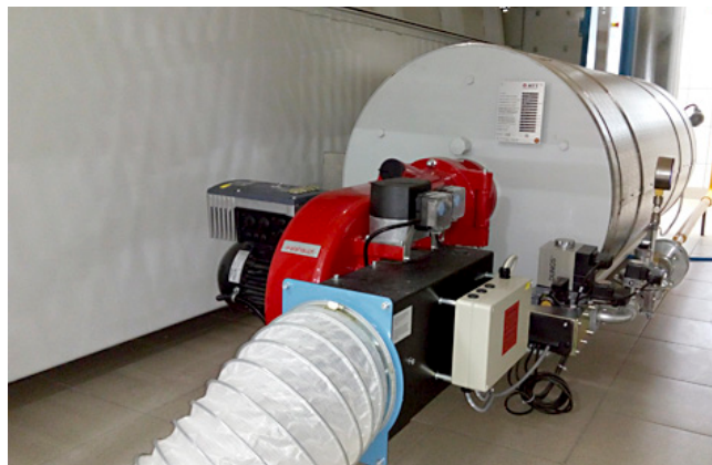
Горелка Weishaupt на термомасляном котле
