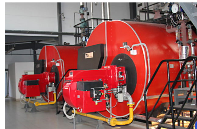
Паровая котельная с горелками Weishaupt, г. Тула
