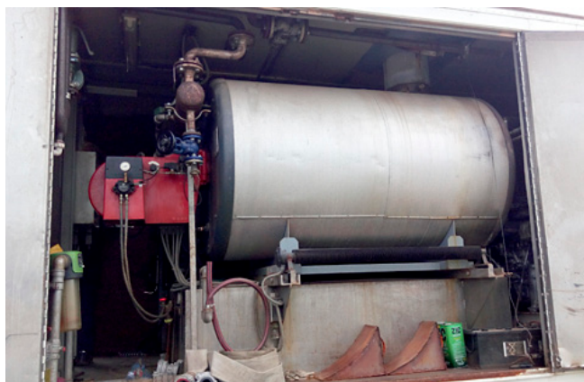
Санационная установка с горелкой Weishaupt, г. Батайск
