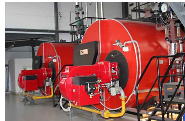
Паровая котельная с горелками Weishaupt, г. Тула
