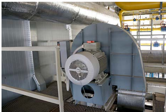
Вентиляторная станция над горелкой WKGL 70
