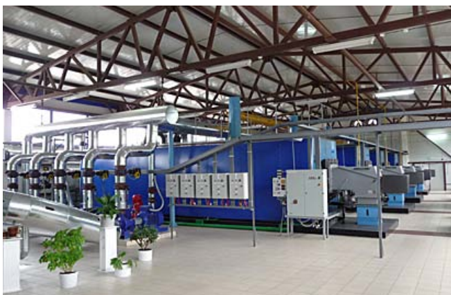
Муниципальная котельная, г. Сафоново, 2010 г.
