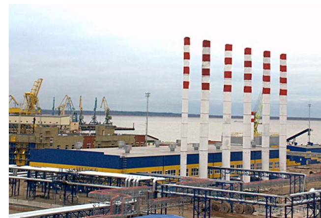
Термо-маслянная котельная мощностью 121 МВт, 2010 г.
