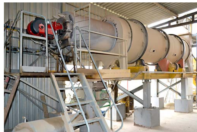
Горелка WM-G 10/4-A на сушильном барабане производства ПАО «Кредмаш»
